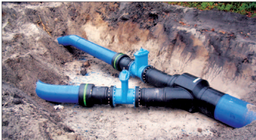
Bild 3: Formteilbaugruppen/Schweißkolonnen und Absperrarmaturen
